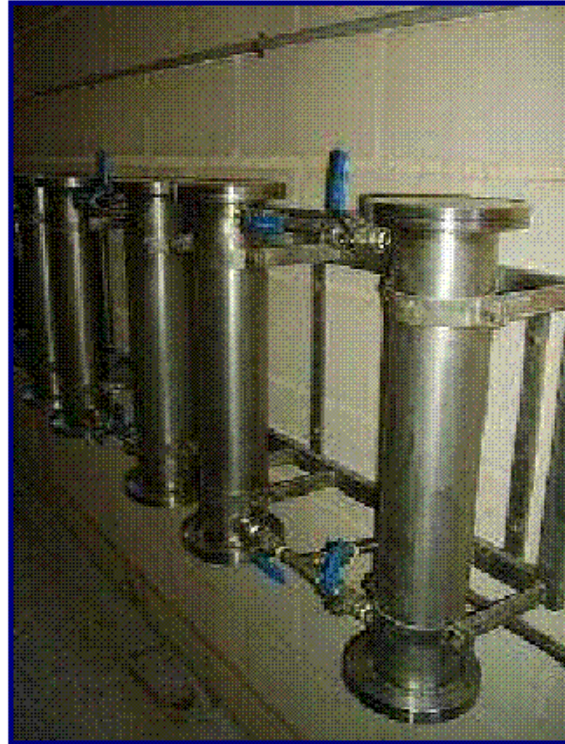
Figura III.3.- Detalle de los seis cilindros de acero inoxidable del sistema de purificación del aire cero, fabricados en el Taller Mecánico del SACE de la Universidad de Murcia.
